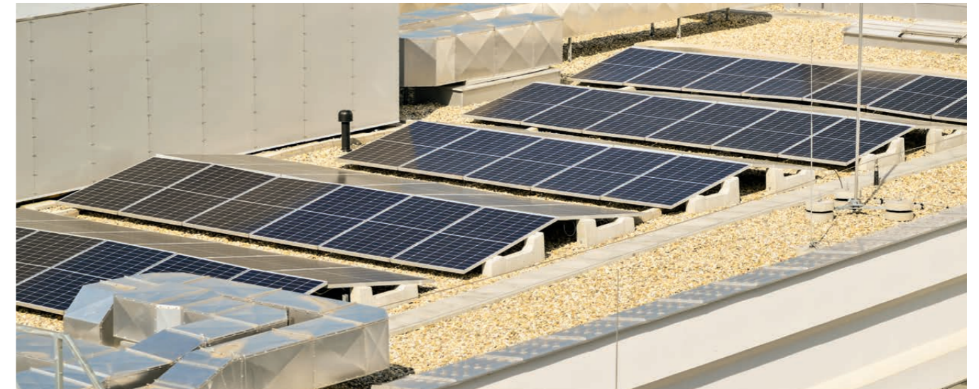
Laufend werden die ORF-Standorte mit Photovoltaik ausgestattet.
